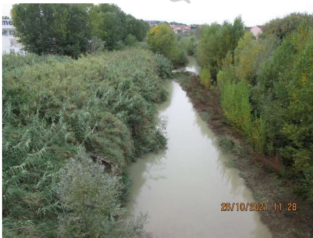
Foto n.4 – Come si presenta oggi il letto del Fiume Misa in corrispondenza della sezione di attraversamento del Ponte Sospeso. La fitta vegetazione rappresenta comunque un ostacolo al normale deflusso delle acque incanalate verso la foce.
